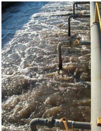
Figura 3.2. Vasca di ossidazione presso l'impianto Capoluogo
