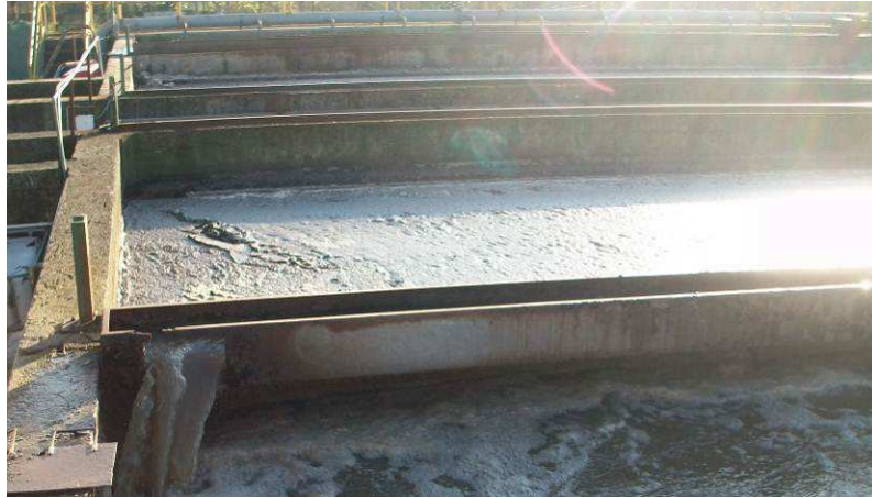
Figura 3.3. Vasca di sedimentazione con fango flottante (impianto Capoluogo)
