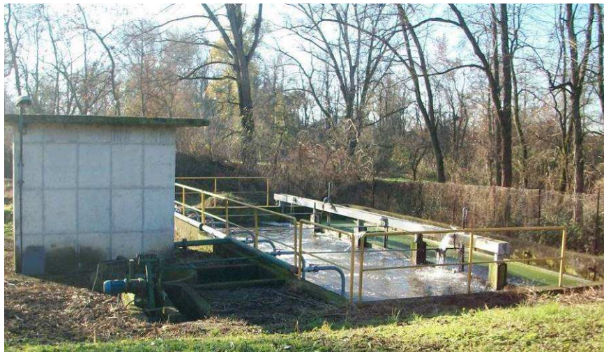
Figura 3.4. Impianto di depurazione Cadignano.
